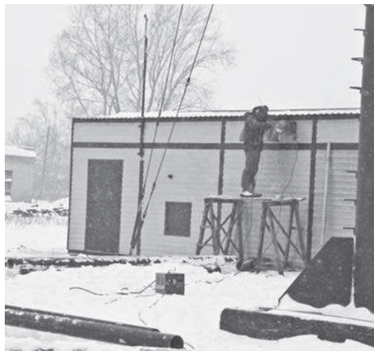
Котельная практически готова к запуску.
