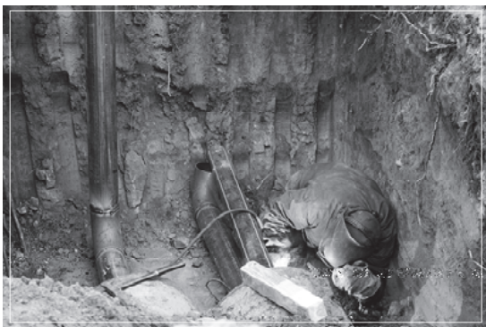
За время работы с фондом модернизации и развития жилищно-коммунального хозяйства муниципальных образований Новосибирской области, в районе проведена модернизация 7 котельных в комплексе с тепловыми сетями
